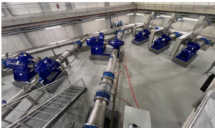
м. Мюнстер (водоочисна та водопровідна станція)
